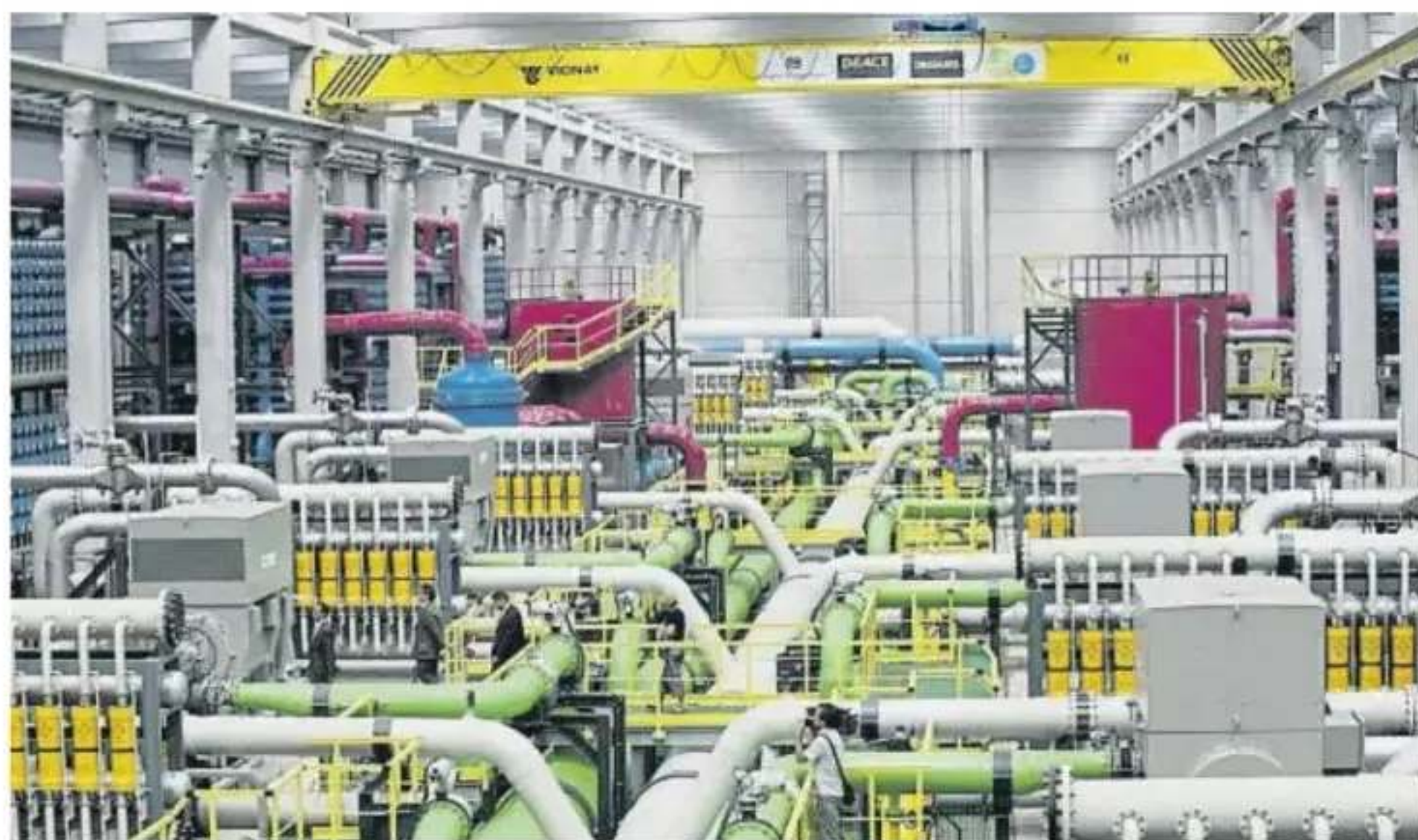
Interior de la planta desalinizadora de El Prat de Llobregat
